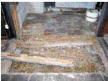
修理前：土台腐蝕状況 クリ材の土台がシロアリの被害を受けた
