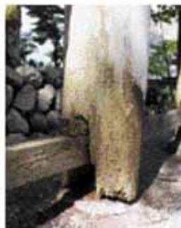
修理前：大柱根元腐蝕状況 長年の雨水、雪解水で腐朽した
